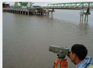
Hình 4. Quan trắc lún tuyến băng tải cà cảng xi măng của nhà máy xi măng
