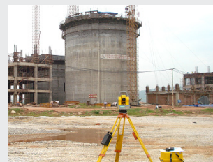
Hình 8. Quan trắc độ nghiêng silo nhà máy xi măng
