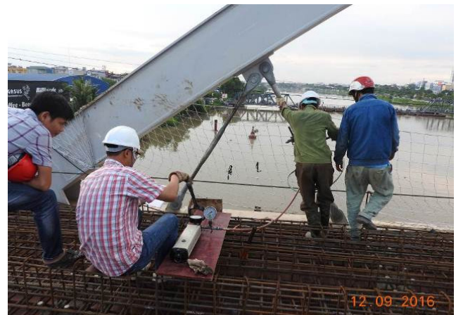
Hình 8. Xác định lực dọc trong thanh bằng thiết bị chuyên dụng (đo trực tiếp)
