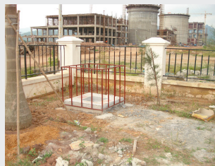
Hình 2. Mốc chuẩn đo lún sau khi hoàn thành
